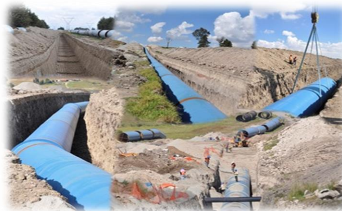
Sistema de conducción (3ª línea) en Cutzamala (México)
