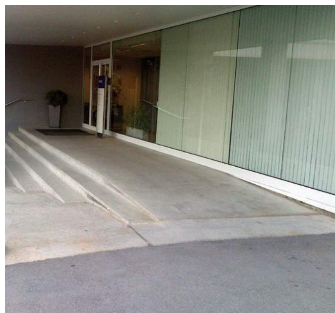
Se muestra una rampa para salvar la escalera de acceso. A destacar que el último peldaño se encuentra en rampa en su parte de conexión con la plataforma, a la que llega la rampa que va cortando los peldaños de la escalera. (Fotografía cedida por Grifols)
