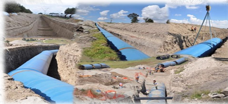
Sistema de conducción (3ª línea) en Cutzámala (México)
