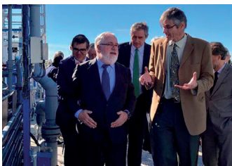
Miguel Arias Cañete (izquierda) recibe las explicaciones de Frank Rogalla, director de Innovación de Aqualia, durante su visita a las instalaciones del Proyecto All-gas. Entre ambos, Félix Parra, director General de Aqualia.
