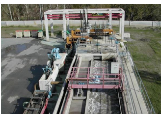
Planta depuradora de Guadix, Granada.
